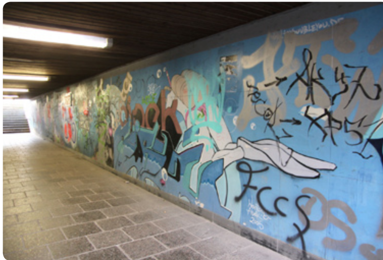
Kaum noch erkennbar: das thematische Graffiti am Eingang des Tunnels unter der Erlanger Allee
