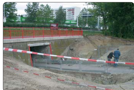
Foto unten: Bauarbeiten an der Unterführung zwischen Lobeda-Ost und Lobeda-West. Die Unterführung wird vom 10.-13. August gesperrt; in diesen 4 Tagen müssen Fußgänger und Radler den Ampelübergang Stadtrodaer Straße in Höhe Platanenstraße (ehemaliges Arbeitsamt) nutzen.
