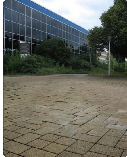
Völlig zerstört: Anwohner beschwerten sich über den durch Baggerfahrten zerfahrenen Weg, an dessen Reparatur offenbar gar nicht gedacht wird
