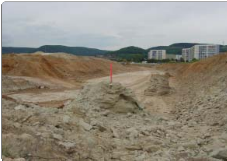
Gewaltige Erdbewegungen an der BAB A4 für die Einhausung der Fahrbahnen entlang des Wohngebietes
