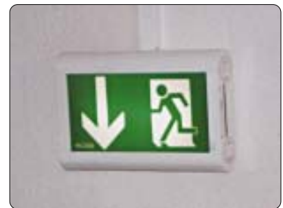
Das Ergebnis: Hoher Sicherheitsstandard; z.B. die beleuchteten Fluchtwegweiser
